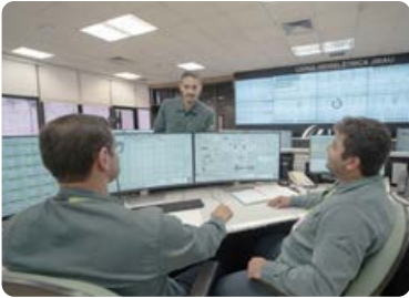
A segurança energética foi reforçada com o sistema back-to-back .
