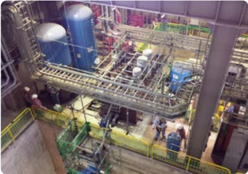
Técnicos brasileiros e chineses participam do teste da subestação blindada (acima e na página ao lado).
