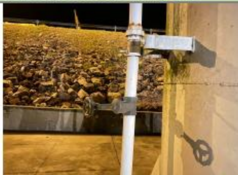
PERIGO EXISTENTE ANTES DA LIBERAÇÃO DE ENTRADA
