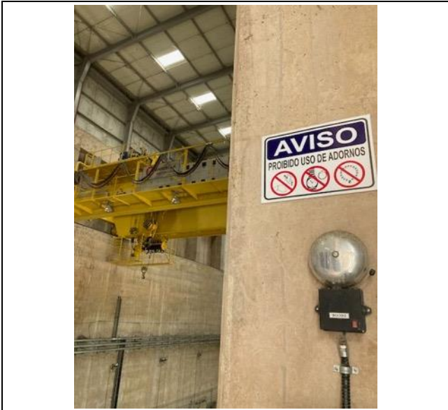
Foto 55: Alarme e sinais de alerta na usina de energia
