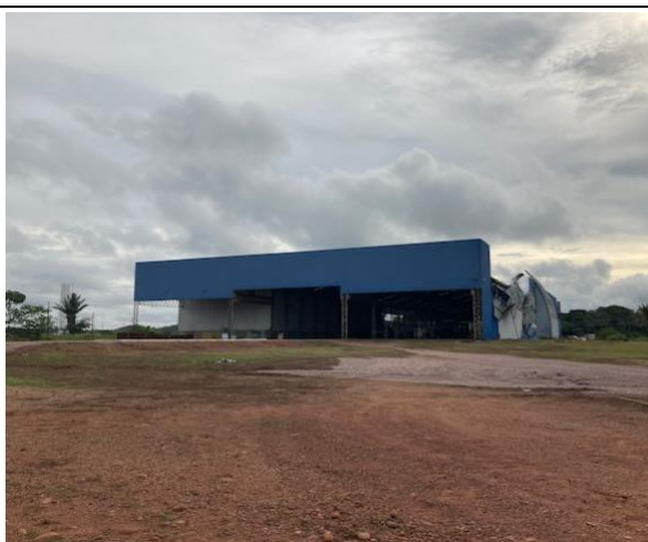
Foto 77: Galpão danificado em Nova Mutum Paraná, atualmente utilizado para armazenamento de trilhos ferroviários históricos
