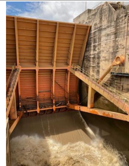
Foto 42: Comporta do vertedouro parcialmente aberta
