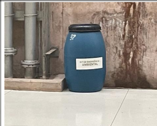
Foto 59: Kit de emergência ambiental na casa de força
