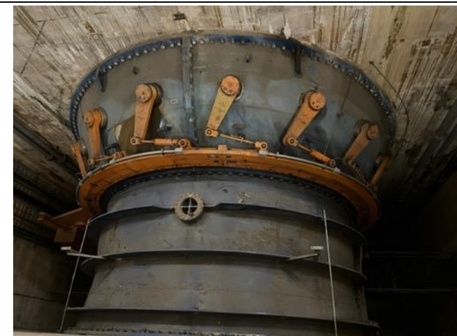
Foto 66: Distribuidor de turbina bulbo, vista de cima
