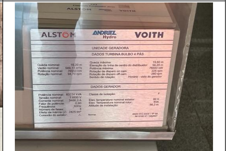
Foto 60: Dados da turbina da usina de energia da margem direita
